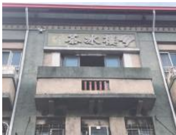
圖 3 「三樓冰茶室」之「三」字已傾圮、「室」字已殘泐
