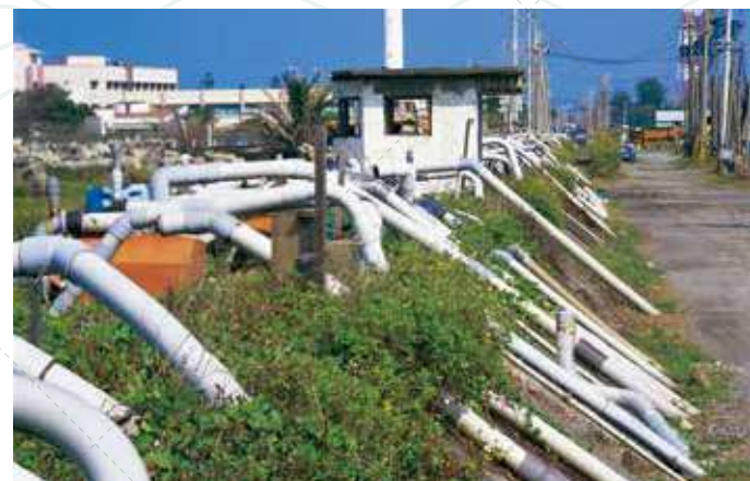
早期架設管線抽取海水進行養殖。(許晉榮攝 / 高雄市野鳥學會提供)
