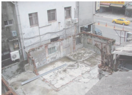
圖 28 修復工程前倉庫牆面殘跡
