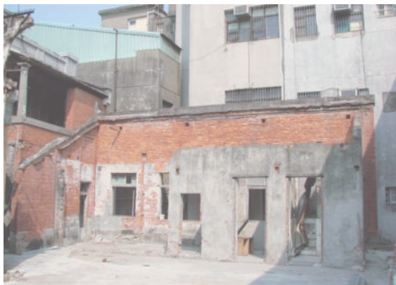
圖 27 修復工程前工友室與廁所牆面殘跡
