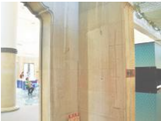
圖 44 高雄火車站原壹、貳等待合室牆面之人造大理石裝修（蔡侑樺 2018 年攝）
