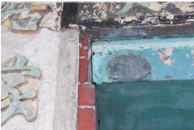
圖 3-10 廖家古厝的電氣番號牌
