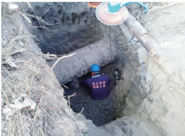
圖 6-2 高雄煉油廠 2019 年 11 月發現廠區路面下方的高雄海軍水道主幹管
