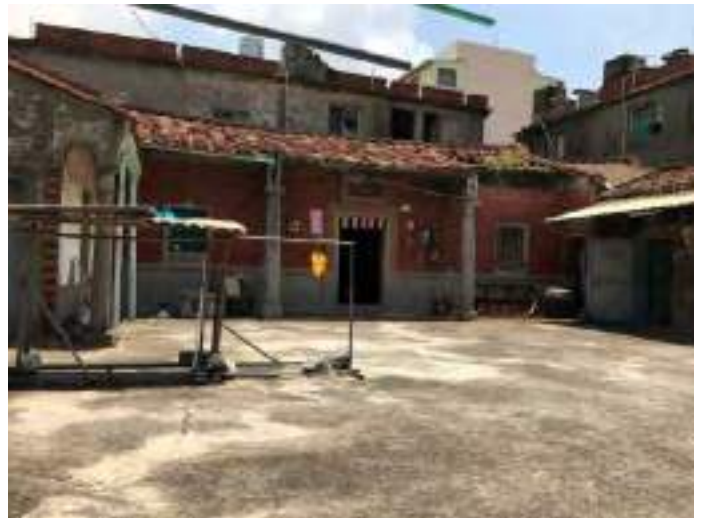
丁 鳳林路東的穎川堂，正身左側屋頂崩落
