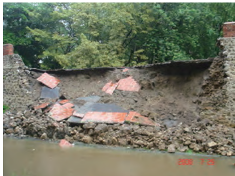
東門崩塌段民國 97 年牆體崩塌狀況
